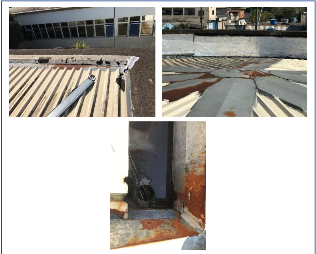
Figura 4-15 – Calhas, rufos e chapins danificadas
